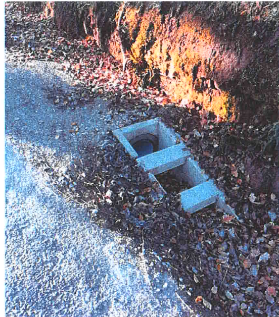
Tête d'aqueduc opérationnelle
